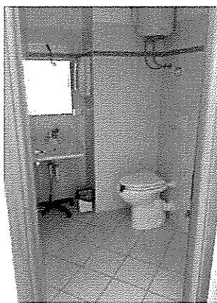
Bagno CMA Srl a norma per persone diversamente abili
